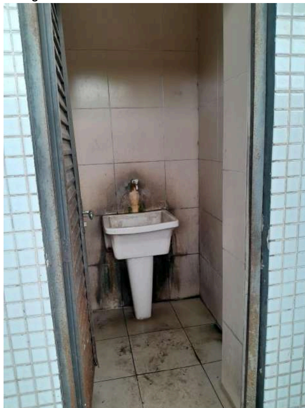
Imagem 16 - Lavatório lateral do Terminal Lado A
