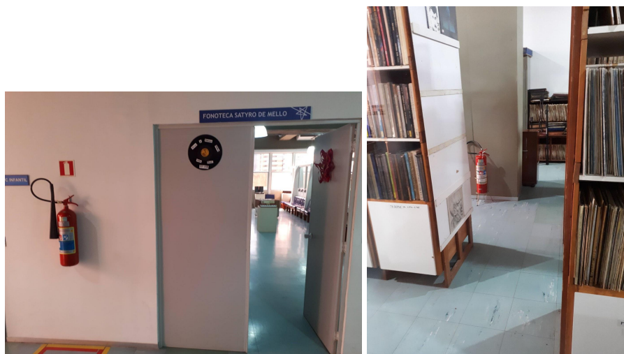
Figura 13 - Extintores de incêndio no espaço da fonoteca Satyro de Mello
