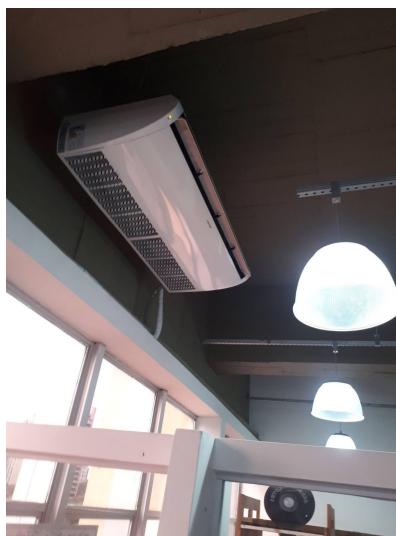
Figura 7- Aparelho de Ar Condicionado no ambiente de armazenamento
