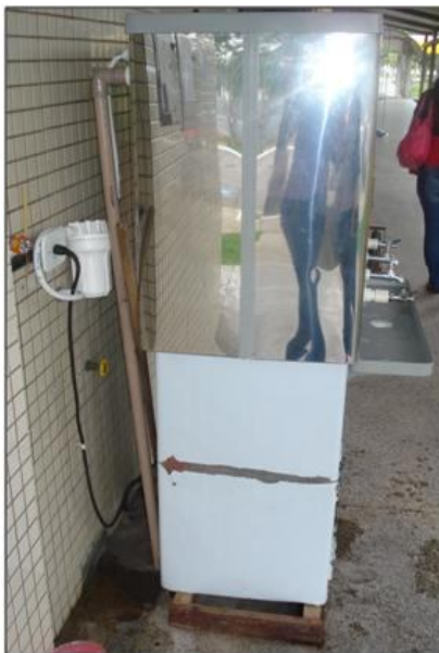
Figura 12: Bebedouro do Bloco B, em uso. Com filtro externo. Localizado na Cidade Universitária da UFPA (Março/2013).
