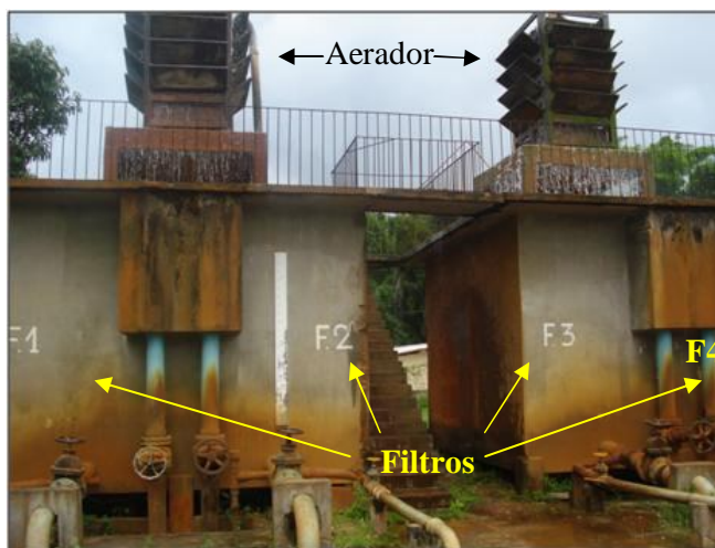
Figura 9: Aerador tipo bandeja de desferrização e Filtros da ETA. Localizado na Cidade Universitária da UFPA (Março/2013).
