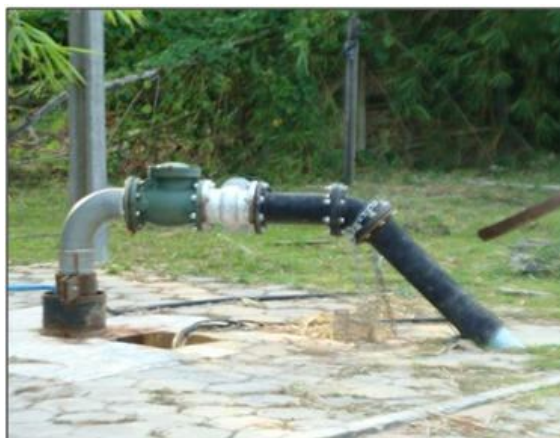
Figura 6: Poço Tubular ETA 3, em uso. Localizado na Cidade Universitária da UFPA.
