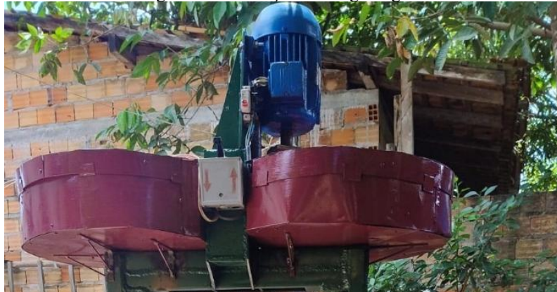
Figura 56 – Proteção das engrenagens
