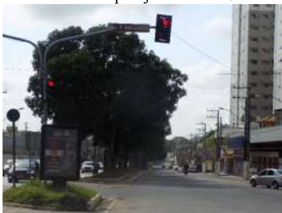
Figura 4.10: GF secundário instalado em coluna simples junto ao GF-02
