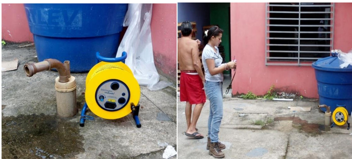
Figura 14: Poço tubular, residencial, de propriedade do Sr. Lázaro.
