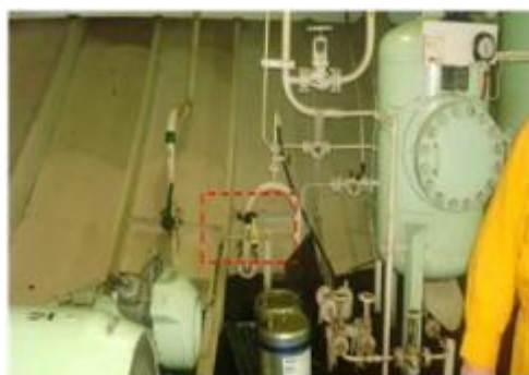
Figura 30- Detalhe de um lacre feito no separador de água e óleo de um navio graneleiro no porto da MRN
