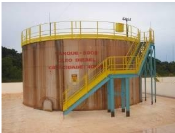
Figura 40 -Tanque com área de contenção dimensionada para toda sua capacidade e impermeabilizada.
