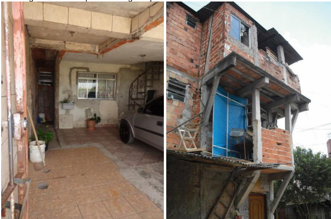
Figura 04 – Exemplos de insegurança estrutural em residências autoconstruídas.
