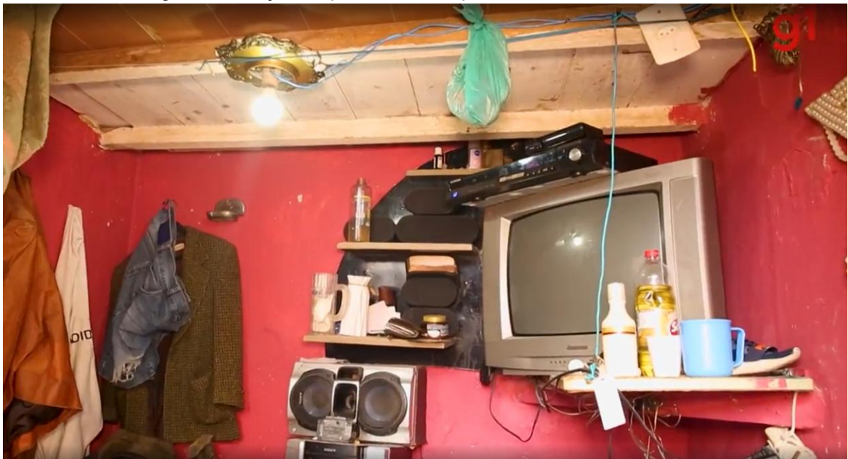
Figura 11 - Fiações improvisadas e expostas na casa do Francisco.
